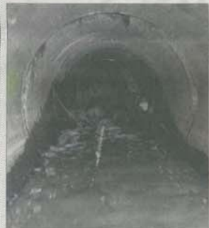
Das Rohr ist bereits derart verstopft, dass nur wenig Wasser in Richtung Stadt abfließen kann.
